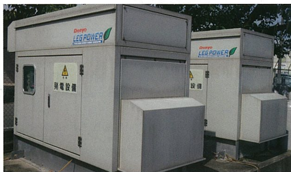
LPガス発電機
