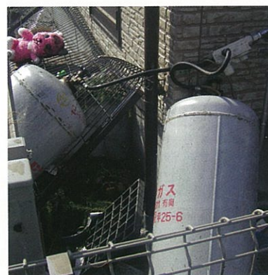
東日本大震災での被災例
