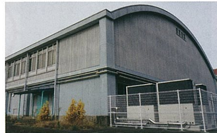
学校体育館に設置したGHP
