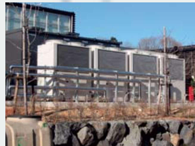
LPガス仕様のGHPも、この国際たくみアカデミー（岐阜県美濃加茂市）など全国の学校や公共施設、事務所、工場、一般家庭などに数多く設置されている。
