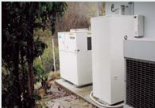
奈良県内の福祉施設に設置された6キロワットのマイクロコージェネ。
