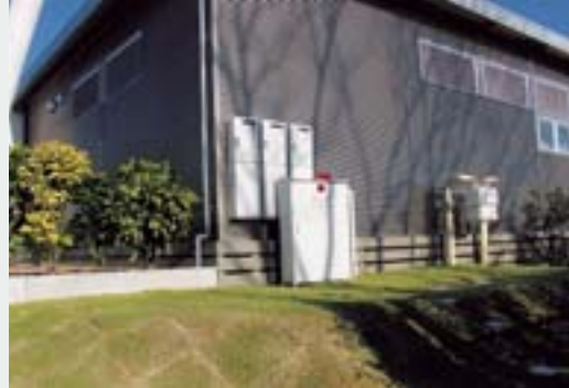
愛知万博の中華レストランに設置されている高効率給湯器。このほか他の飲食店、パビリオンでも給湯用に利用されている。
