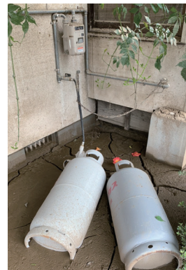
濁流にさらわれた容器
