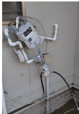
LPガス設備の損傷
