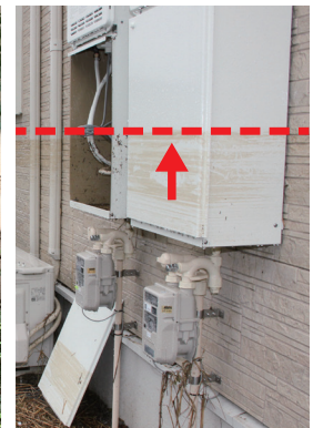
冠水した給湯器
